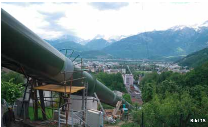
Bewertung des Korrosionsschutzes an einer Wasserdruckleitung
