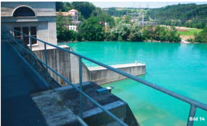
Untersuchung von galvanischer Korrosion an einem Flusskraftwerk
