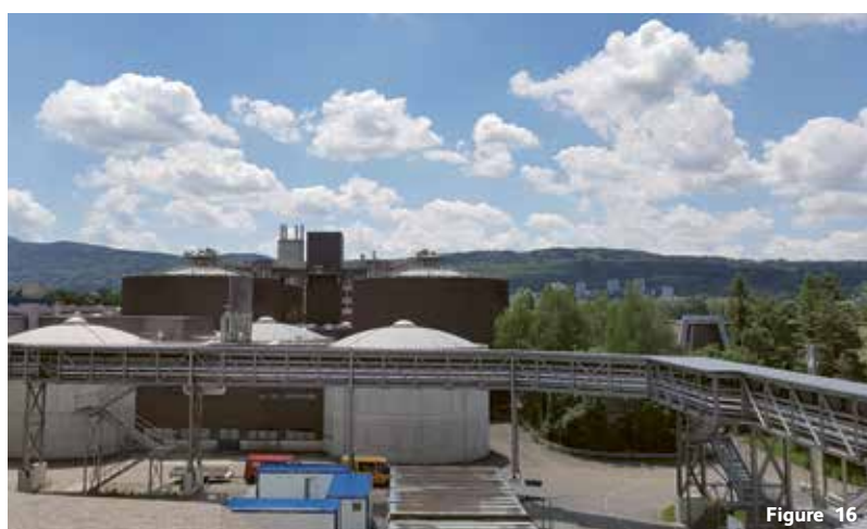
Contrôle de la protection anticorrosion dans une station d'épuration des eaux usées
