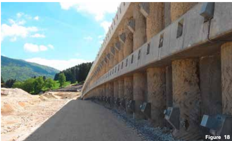
Analyse de la corrosion sur les ancrages d'une paroi de pieux
